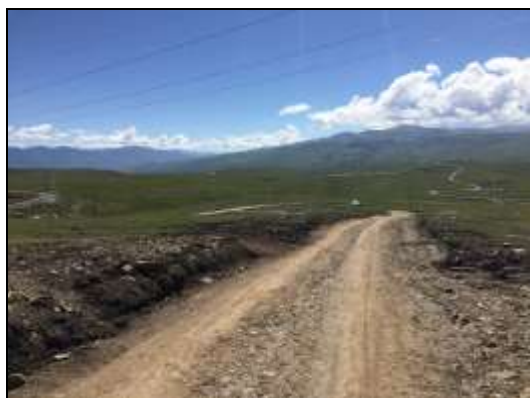
图 3.32 进场道路整改前情况（8月）
